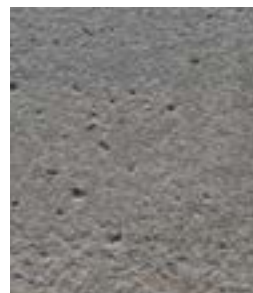
Löcher und Lunker in vorbereiteter Betonoberfläche
