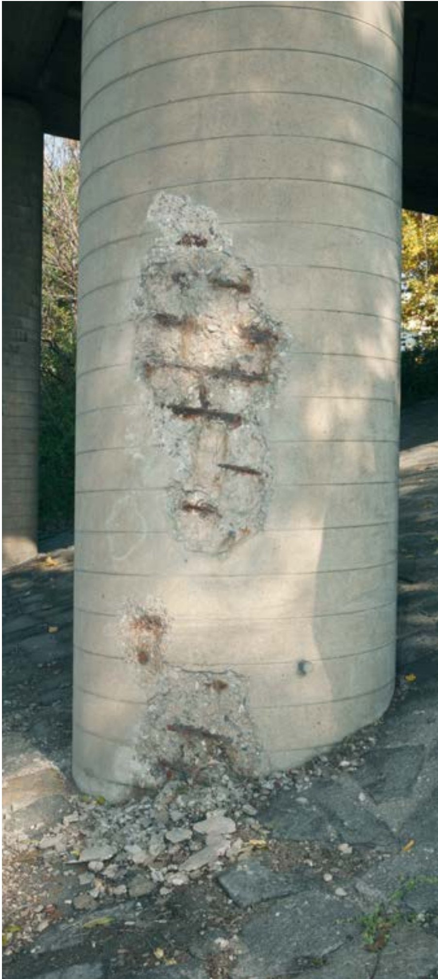
Brückenpfeiler zeigt Schäden durch chloridinduzierte Bewehrungskorrosion. Foto: Wacker Chemie AG
