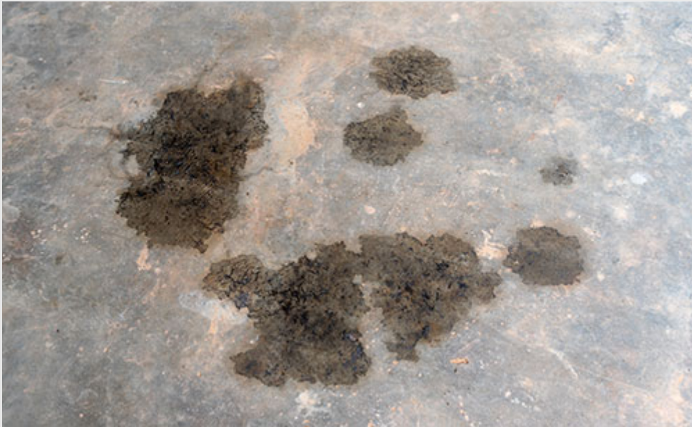
Mit Öl verschmutzter Boden einer Industriehalle. Foto: Adobe Stock
