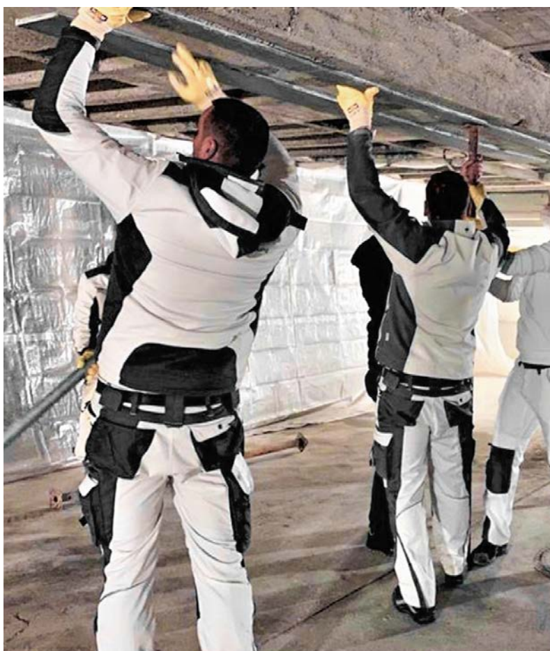
Tiefgarage Eintrachtstraße, München, DE StoCretec-Kompetenzen: StoConcrete Carbon Plate, oberflächig geklebt, StoPox Mörtel standfest
