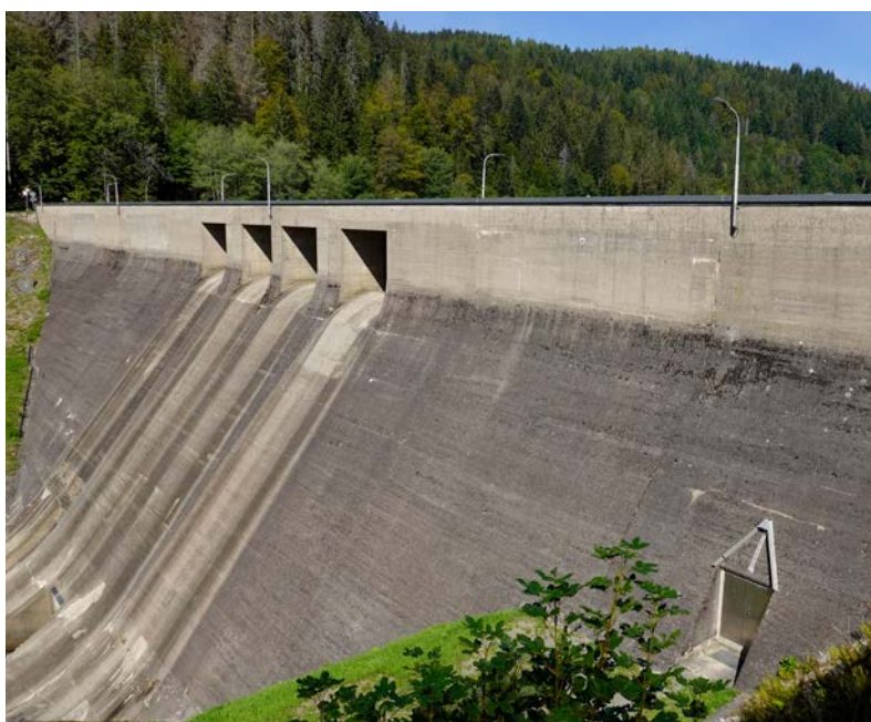
Albtalsperre, Laufenburg, DE
